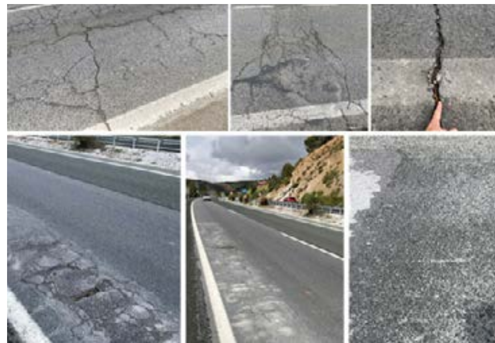
Detalle del estado de deterioro de los firmes previo al extendido del refuerzo con MASAI.
