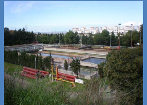
EDAR Sanlúcar de Barrameda
